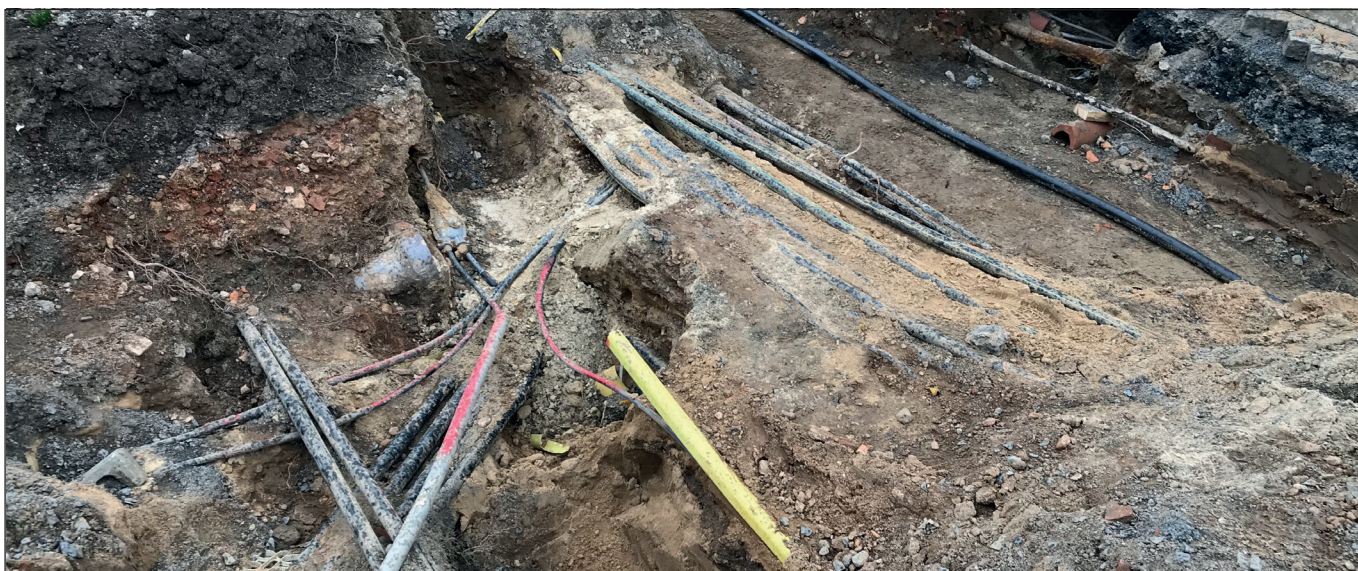
"Kabelsalat" bei den Bauarbeiten
