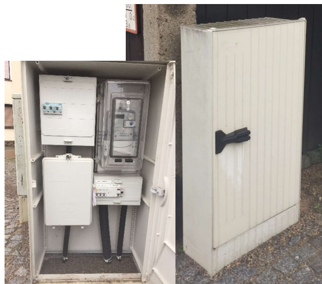
2) Sicherungskasten (Schlüssel AN 1)
