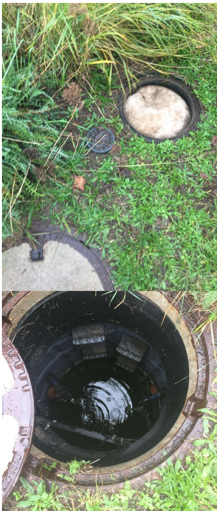
2) Wasserzählerschacht und Pumpenschacht
