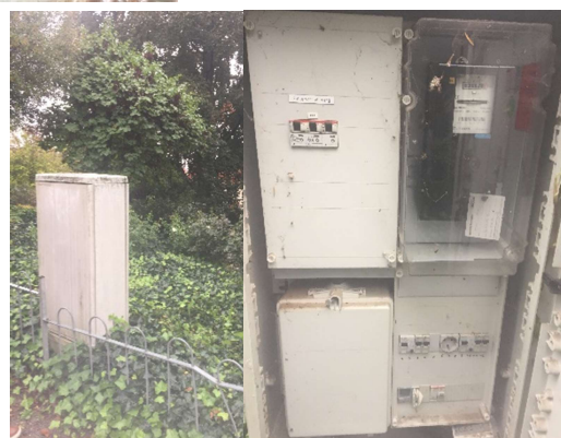
3) Sicherungskasten (Schlüssel AN 1)
