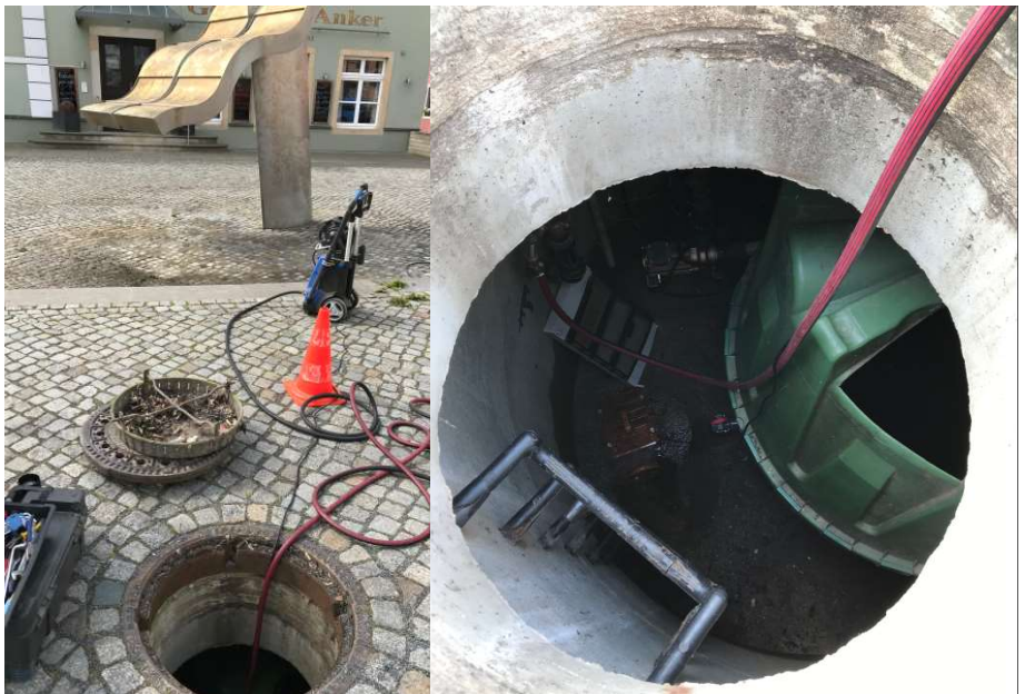
3) Pumpenschacht und Stromkasten
