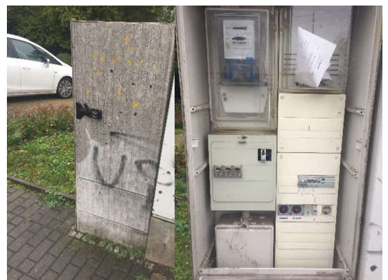
4) Sicherungskasten (Schlüssel AN 1)
