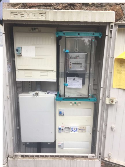
3) Sicherungskasten (Schlüssel AN 1)
