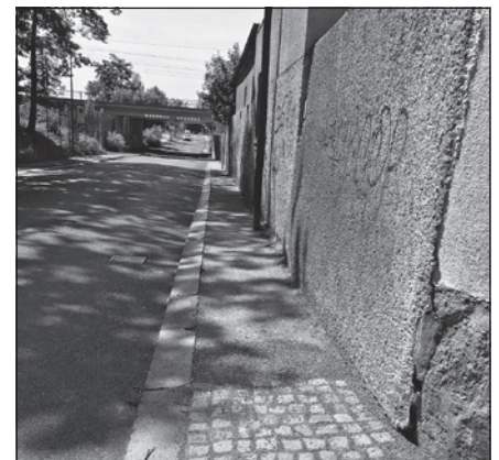
Radebeul Instandsetzung Gehweg Weintraubenstraße vor der Jugendherberge nach den Starkregenereignissen
